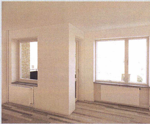
Nye radiatorer under vindue -eks.
